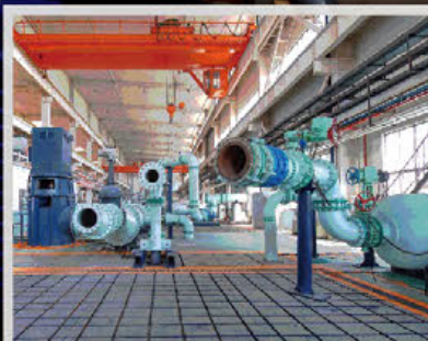
高压试泵站 Pump Test Station
