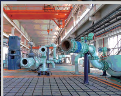
高压试泵站 Pump Test Station
