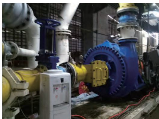
昆明地铁 Kunming Metro
