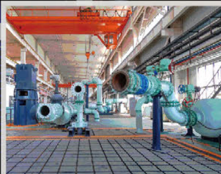
Estación de bombeo de prueba de alta presión
