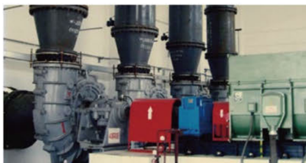
Участок обессеривания электростанции Вэйфан в пров. Шаньдун 山东潍坊电厂 脱硫现场
