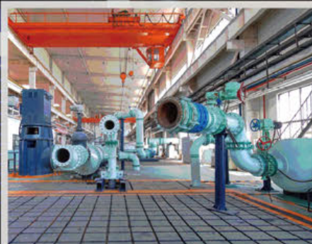
Испытательная насосная станция высокого давления 高压试泵站
